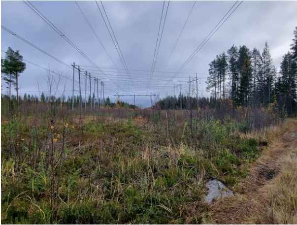
Kuva 5. Kaava alueella sijaitsevia sähkölinjoja.
