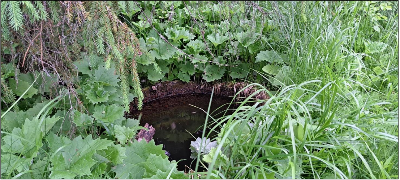
Kuva 11. Lähteellä on betonirengas ja kansi puuttuu.
